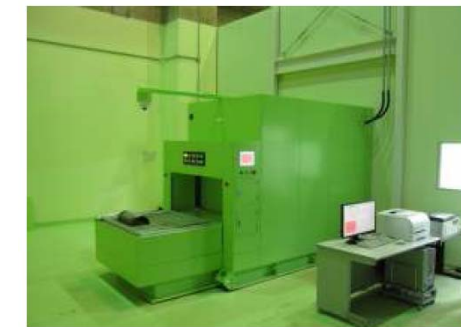
クリアランスレベル検認装置
